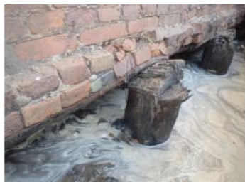
Funderingsschade (palen en op staal gefundeerd)
