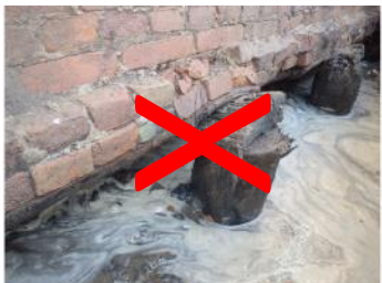
Funderingsschade (palen en op staal gefundeerd)
