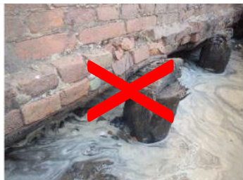
Funderingsschade (palen en op staal gefundeerd)
